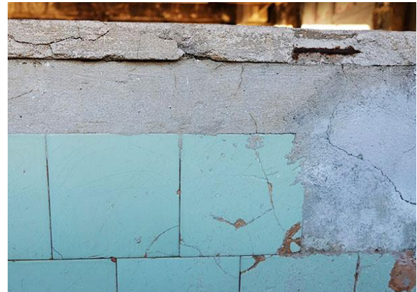
parapet i betonska klupčica – detalji oštećenja
